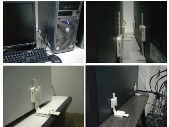
図2. サーバの転倒防止治具の設置状況
